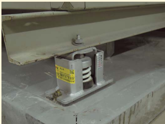
風機槽鐵基座搭配BKS
